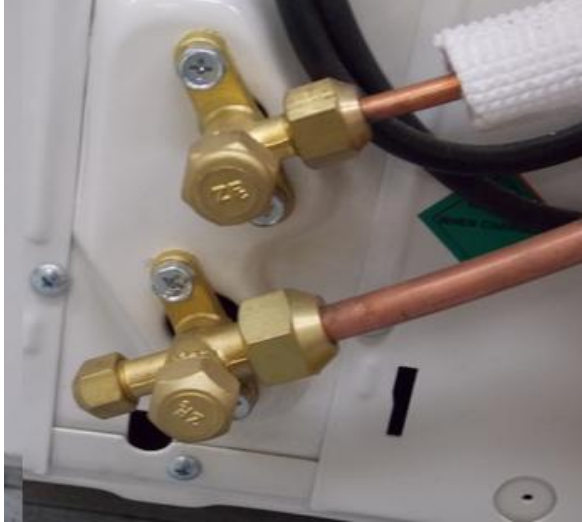
Válvulas de servicio.
